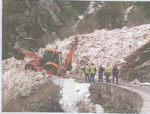
Une avalanche de 8 m de haut et de 40 m de long est descendue du couloir de la Vierge sur la RD 930 isolant le village d'Aulon. Photo Claire Lagadic.
