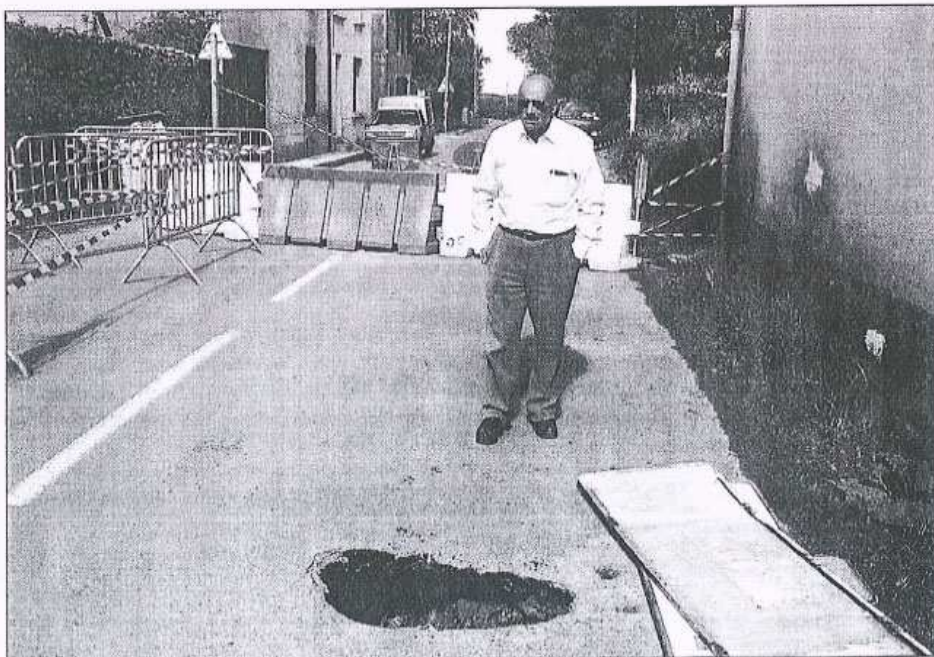
■ Guy Serres, maire d'Anères, l'air dépité devant le trou apparent sur la RD 938 qui fait l'objet d'une déviation depuis le mois de mars. Photo DDM - G. C.
